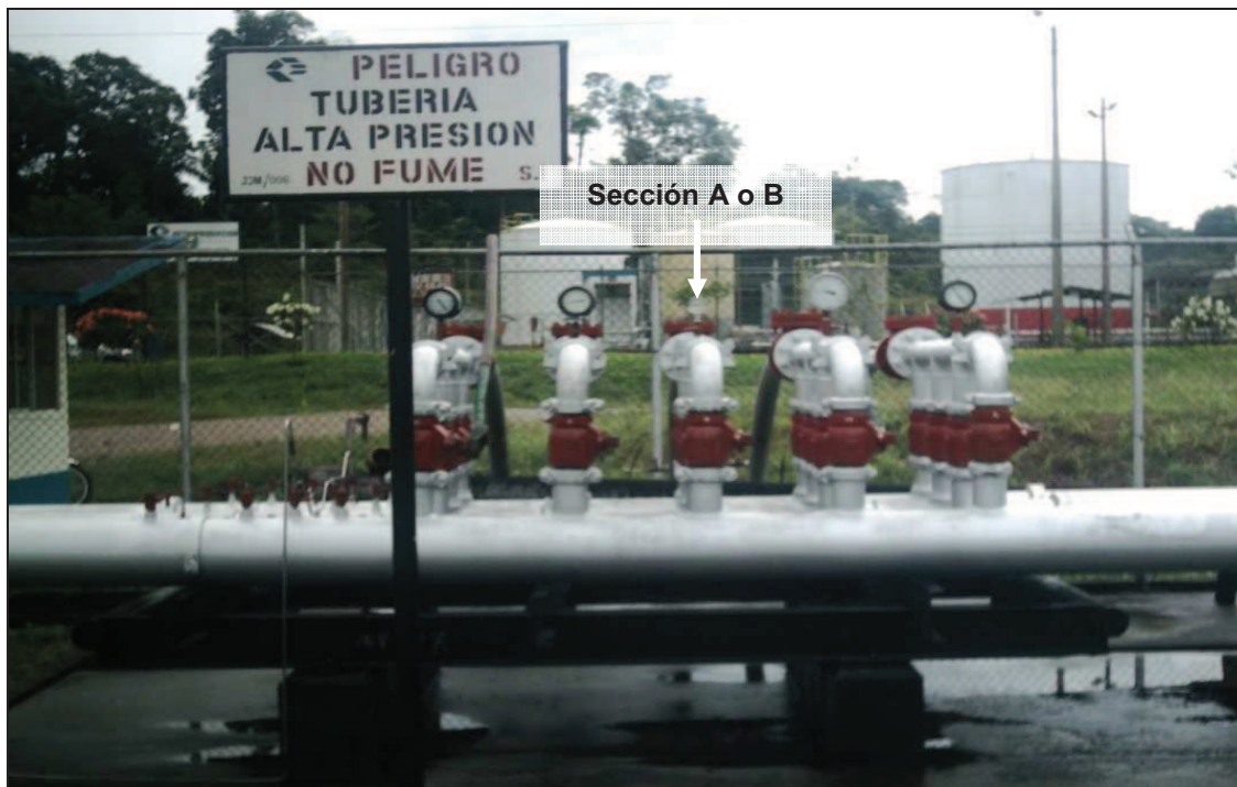
Foto No 2.3. Sección A ó B del Múltiple
