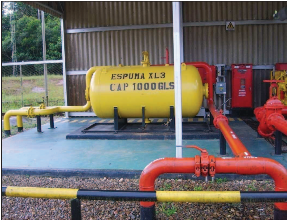
Foto No 2.29. Tanque de Espuma (1000 Barriles)
