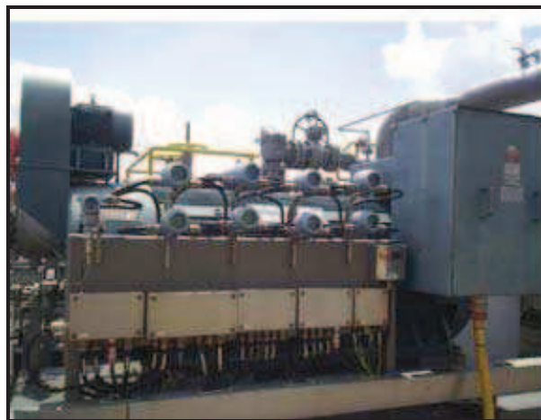
Figura No 3.39. Instrumentación de la bomba multifásica
