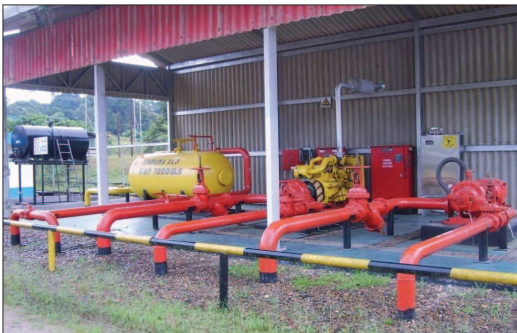
Foto No 2.26. Bombas y Tanque Horizontal de Espuma
