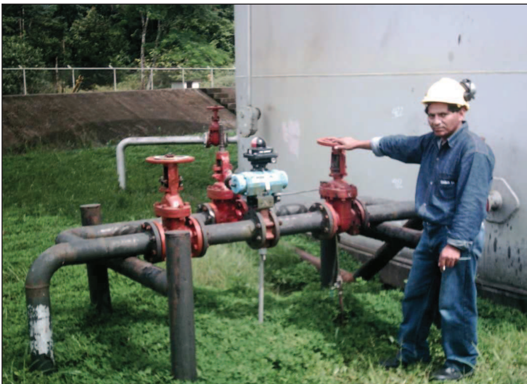
Foto No 2.22. Juego de Tuberías y Válvulas del Sistema de Recirculación
