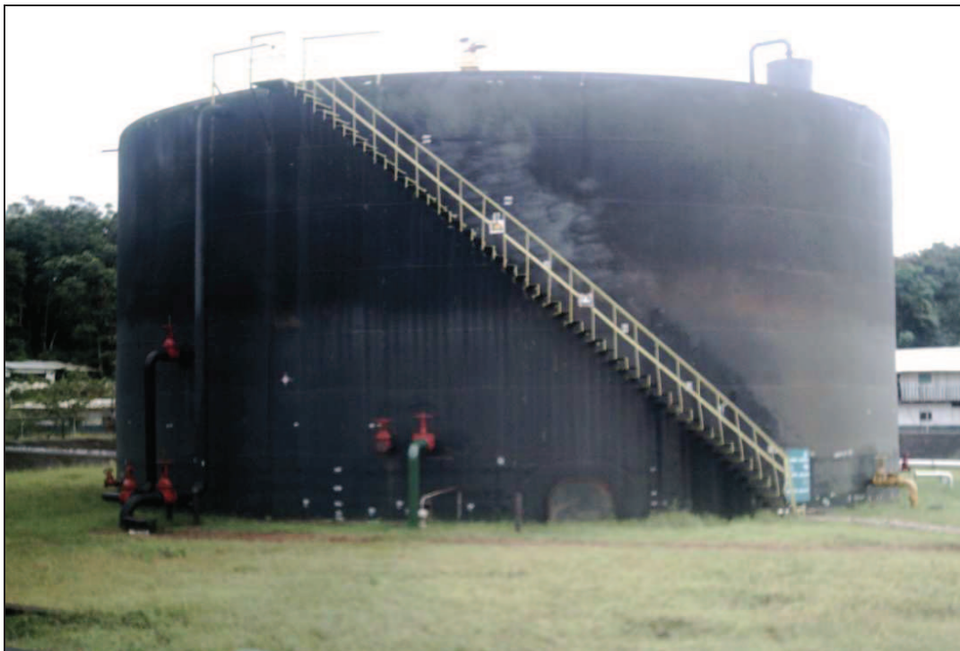
Foto No 2.14. Tanque de Lavado (24680 Barriles)
