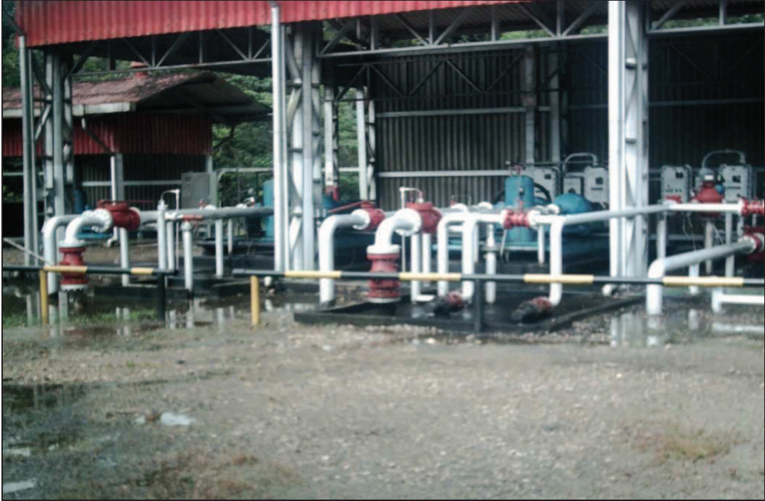
Foto No 2.19. Bombas Triplex de Transferencia a Oleoducto
