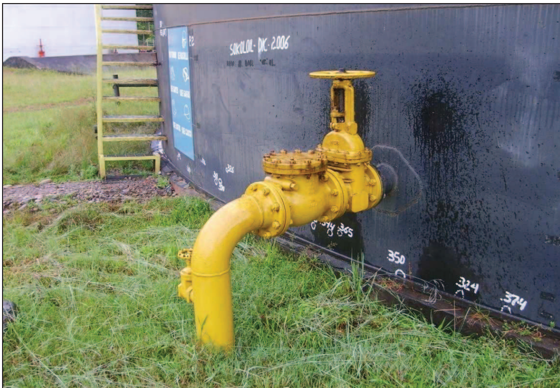
Foto No 2.24. Línea de entrada de recirculación a Tanque de Lavado
