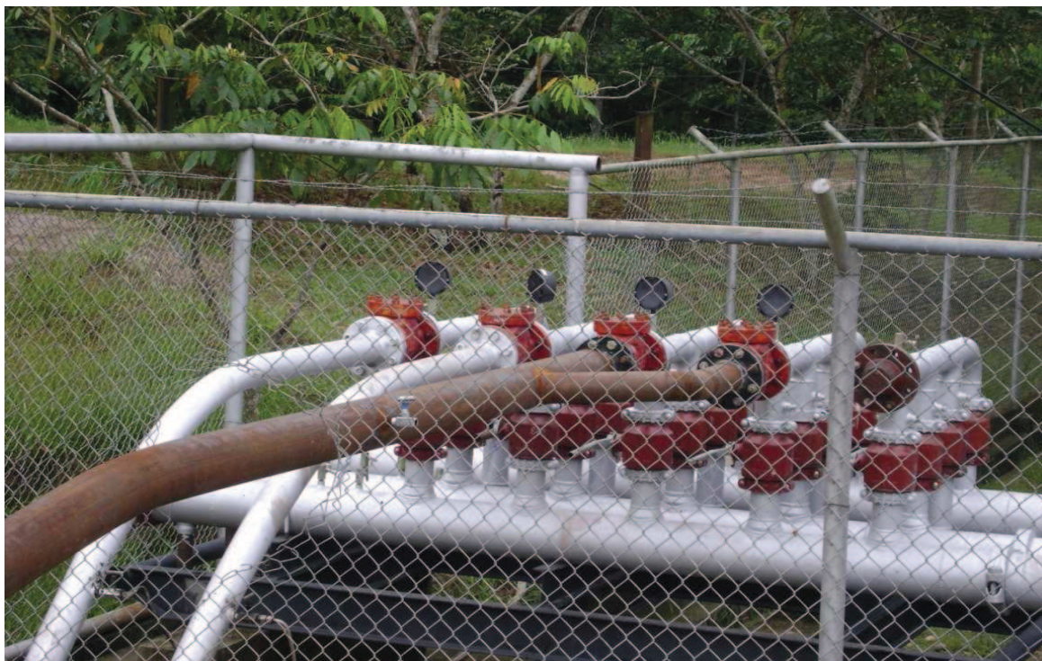
Foto No 2.7. Sección D del Múltiple
