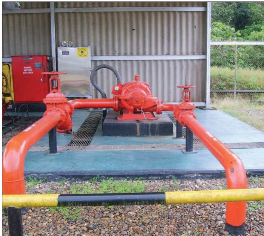
Foto No 2.27. Bomba Eléctrica Marca MARATHON, 150 HP
