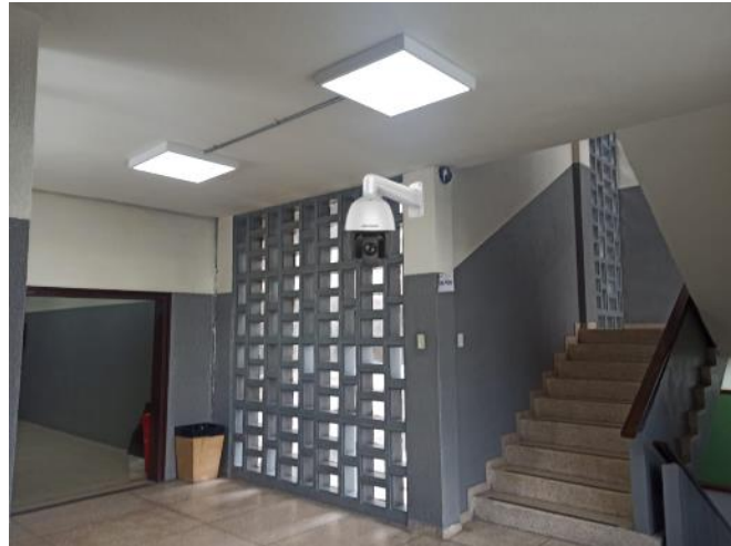
Figura 2.25. Ubicación equipos en acceso.
