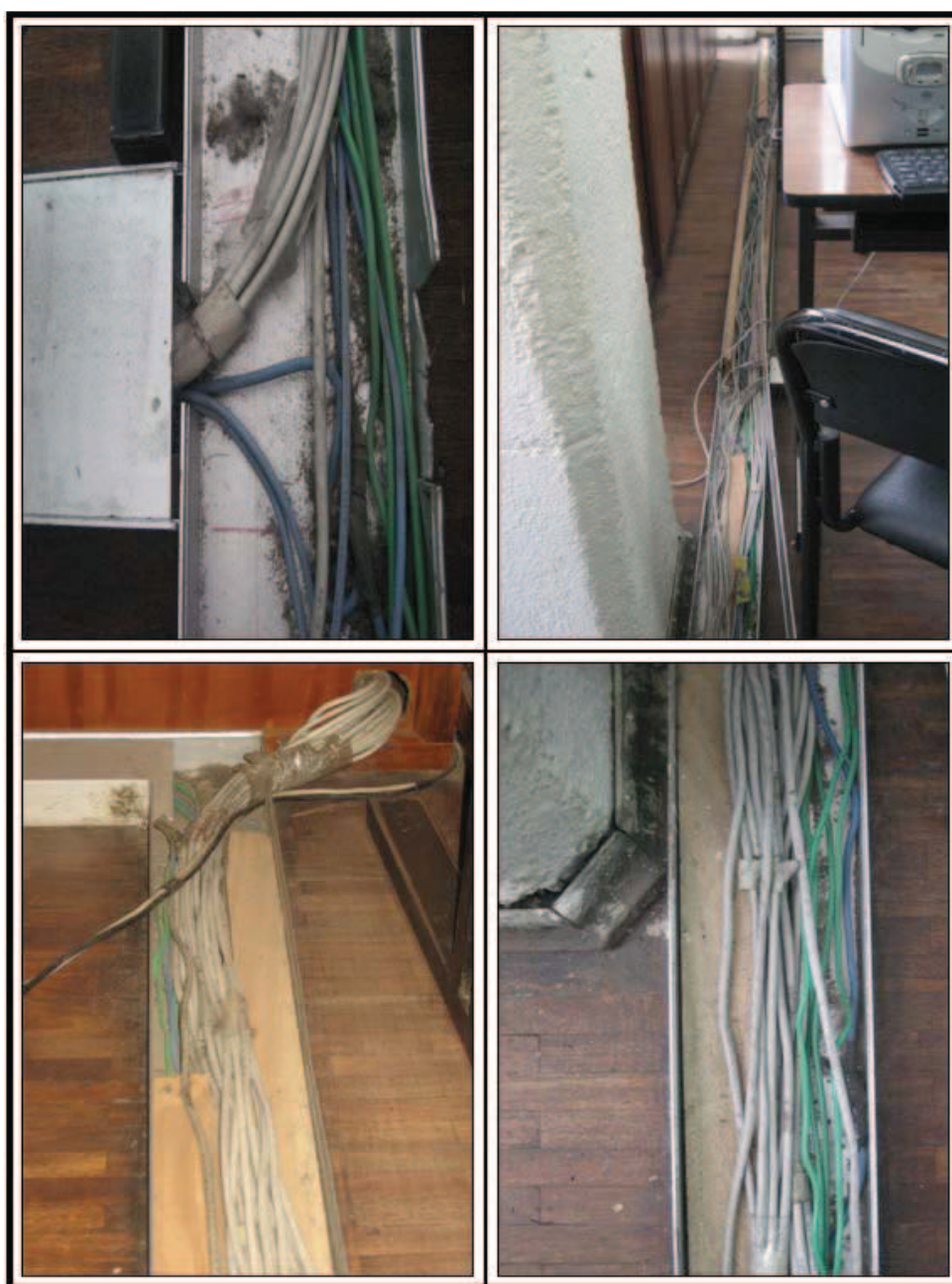
Figura 2-1. Estado en el que se encontraba la red.
