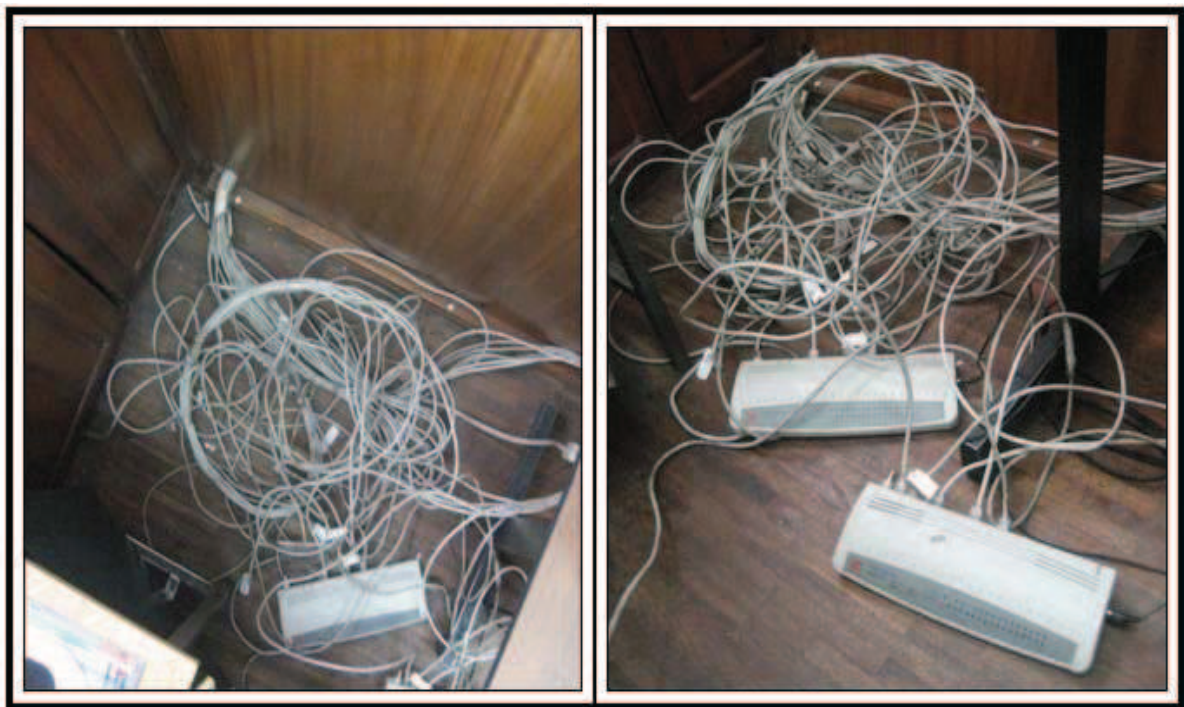
Figura 2-5. Cables provenientes de los puntos de datos existentes.
