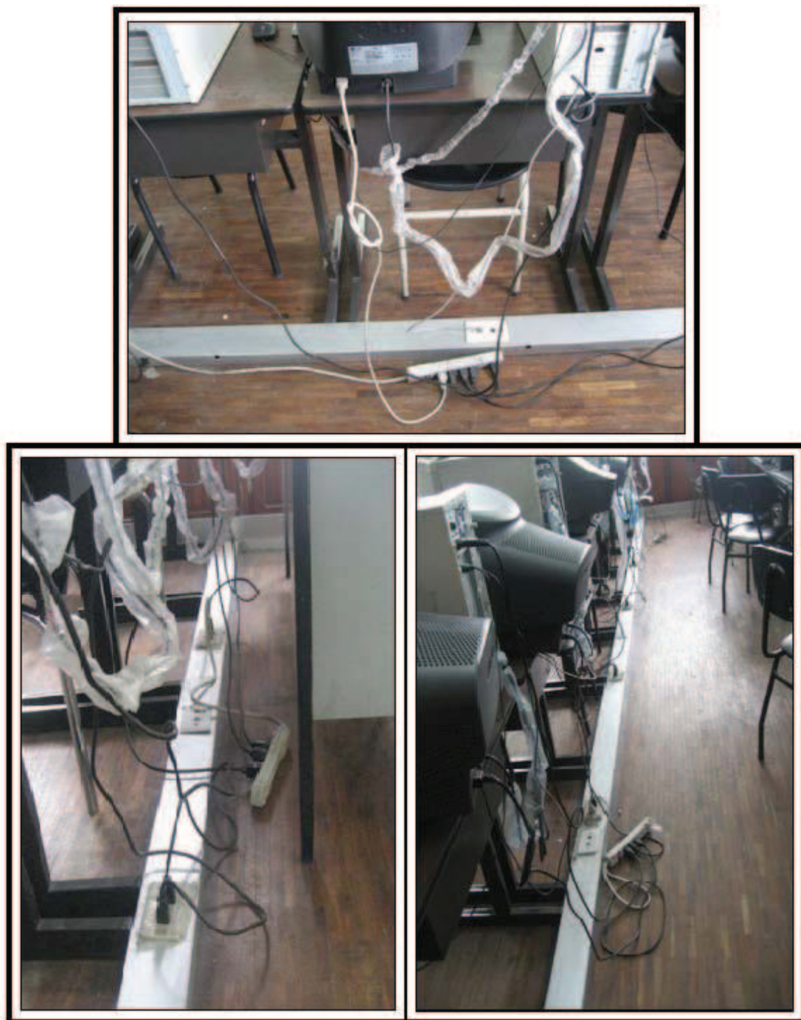
Figura 2-4. Corta-picos existentes por la falta de puntos eléctricos.
