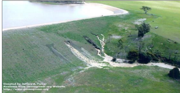
Figura 13. Tubificación en presa de tierra.
