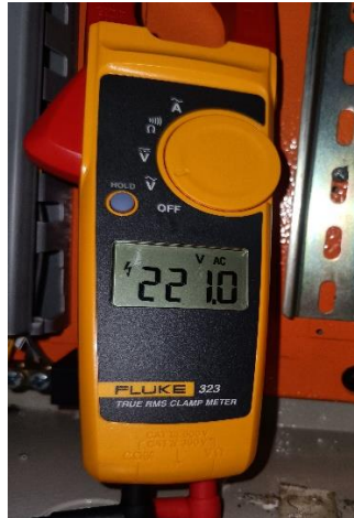
Figura 2.17 Voltaje de línea en el gabinete.
