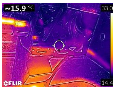
Figura 2.21 Medición con cámara termográfica en puntos de conexión.
