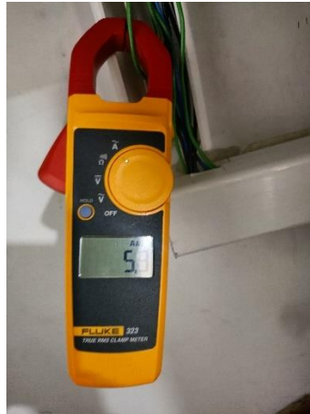
Figura 2.14 Medición de corriente en el tablero principal.
