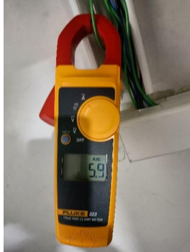
Figura 2.16 Lectura de corriente nominal del circuito de fuerza.
