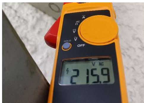
Figura 2.18 Medición en cada luminaria.
