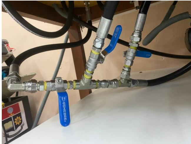
Figura 2.25 Válvulas de paso instaladas
