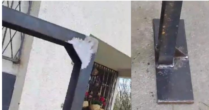
Figura 2.19 Refuerzos soldados en la estructura.
