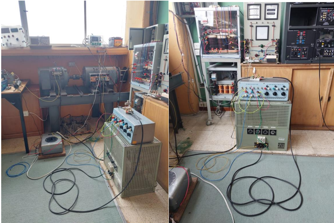
Figura III.1. Conexiones del sistema grupo motor generador y GOV en el cual se realiza las pruebas
