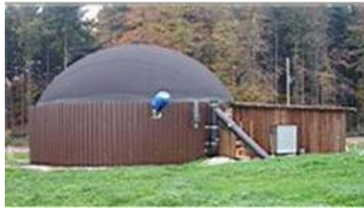
Figura 22. Digestor con cúpula de polietileno y tanque de almacenamiento. [24]
