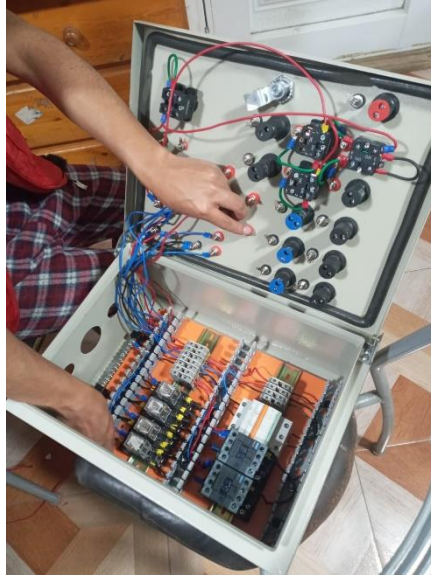
Figura 2.34. Conexiones eléctricas del gabinete.
