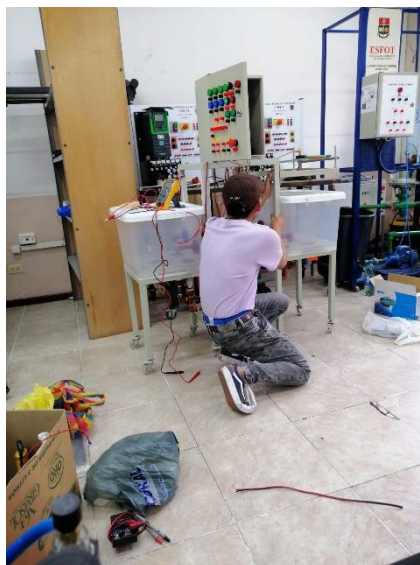
Figura 2.28. Conexiones eléctricas de electroválvulas y bombas.
