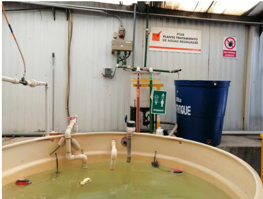
Figura 1.1. PTAR Yanbal Ecuador S.A.
