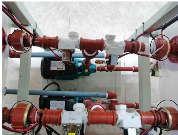
Figura 3.7. Secciones críticas de fuga de agua.
