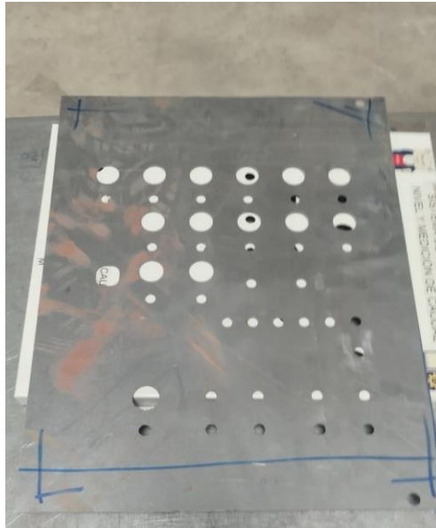
Figura 2.30. Cubierta del gabinete eléctrico.
