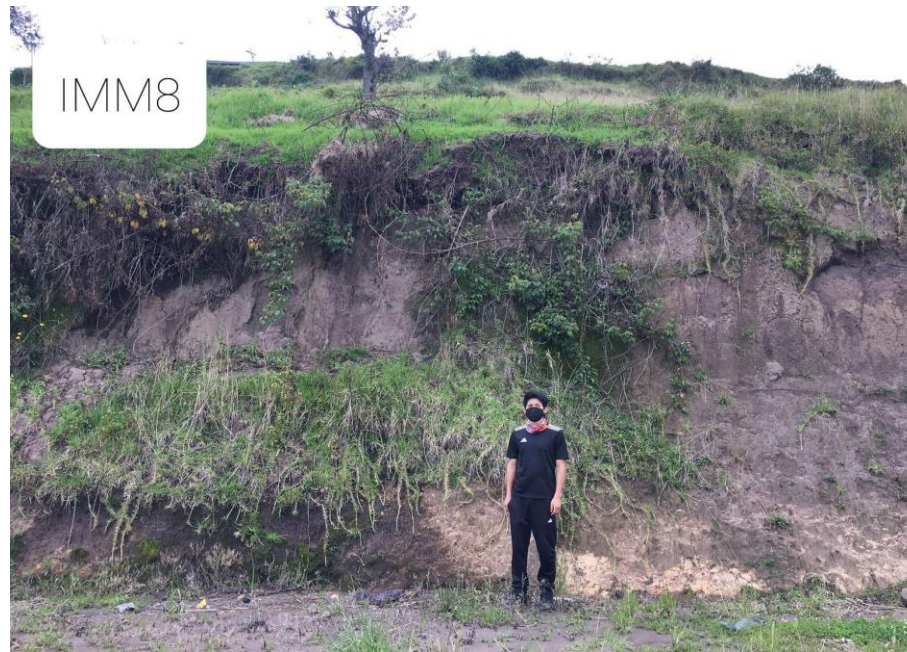
Fotografía IMM8 Caída en el corte vial del barrio de San Luis de Miravalle. Fuente: Marco Yanguicela
