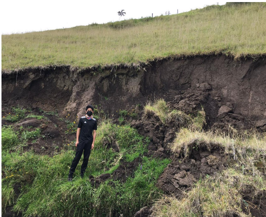
Figura 1.1 Derrumbe en el corte vial del barrio de San Luis de Miravalle. Fuente: Marco Yanguicela
