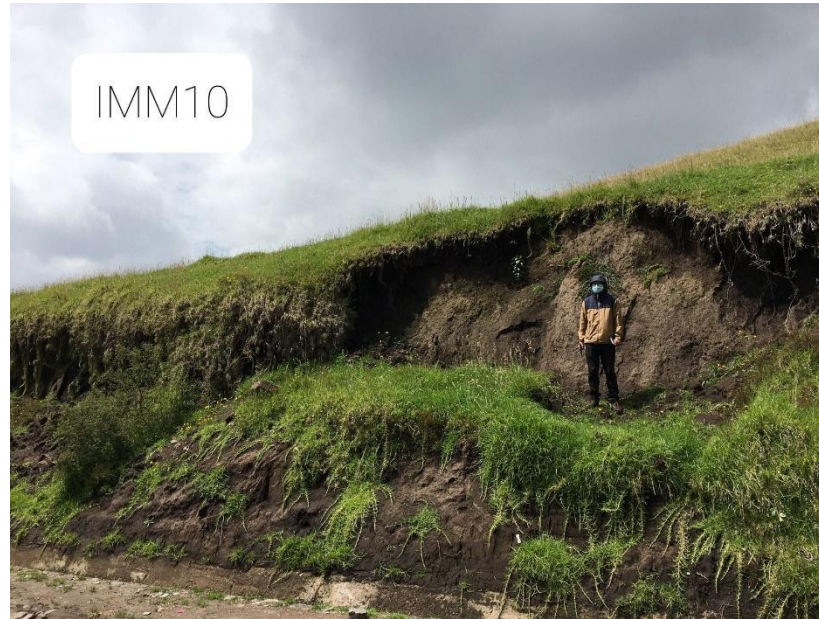
Fotografía IMM10 Caída en el corte vial del barrio de San Luis de Miravalle. Fuente: Marco Yanguicela
