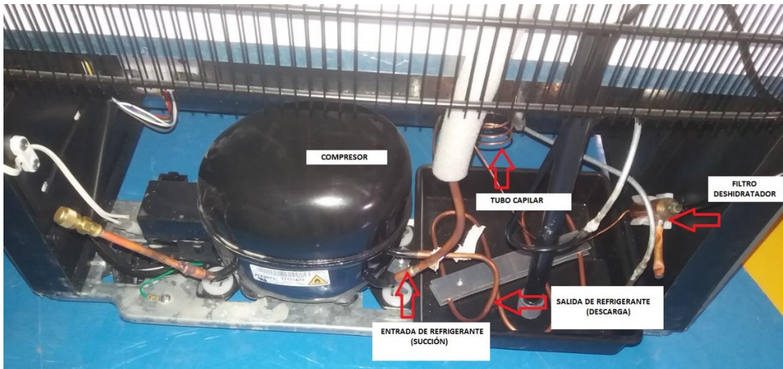
Figura 2.4 Compresor, tubo capilar y filtro deshidratador del sistema de refrigeración.
