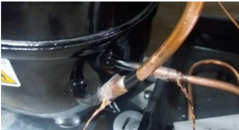
Figura 2.10 Ubicación de sensores en el compresor.
