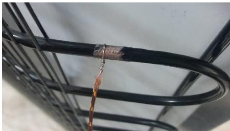
Figura 2.8 Ubicación de sensores en el condensador.
