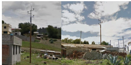
Figura 1. Fotografías de postes pasantes que sostienen la línea de subtransmisión Illuchi 1 – El Calvario.
