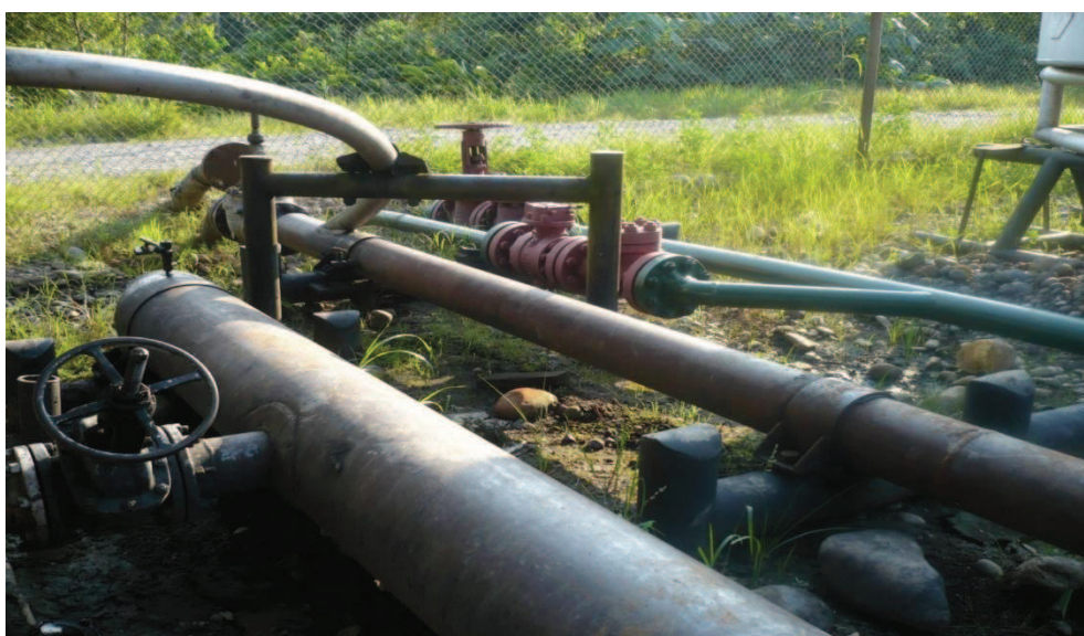
FOTO A.2.17. LÍNEAS DE TRANSFERENCIA DE CRUDO Y AGUA (LÍNEA VERDE) HACIA OLEODUCTO SECUNDARIO AUCA SACHA Y POZO REINYECTOR YUL-06, RESPECTIVAMENTE.
