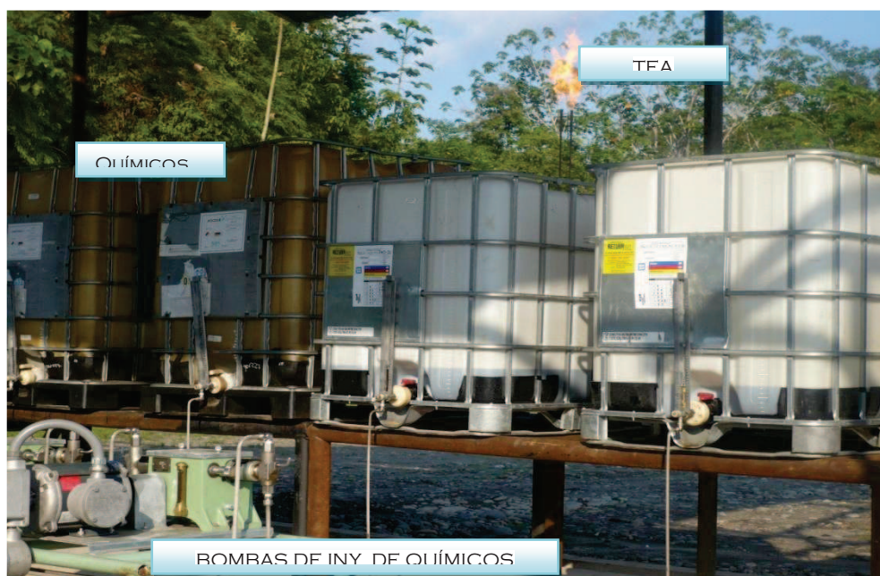
FOTO A.2.7. ÁREA DE INYECCIÓN DE QUÍMICOS. ESTACIÓN YULEBRA
