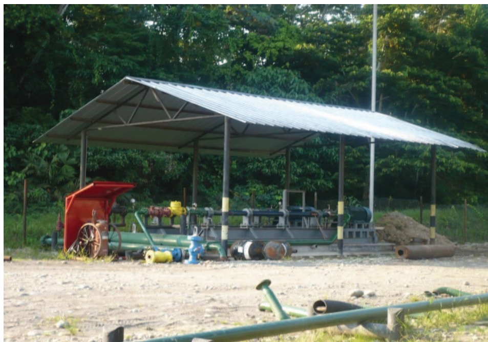
FOTO A.2.12. SISTEMA DE REINYECCIÓN DE AGUA, SISTEMA DE BOMBEO. ESTACIÓN YULEBRA.
