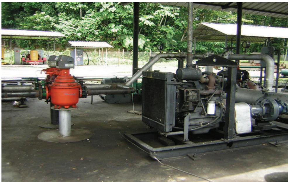
FOTO A.2.16. SISTEMA DE BOMBEO. ESTACIÓN YULEBRA.
