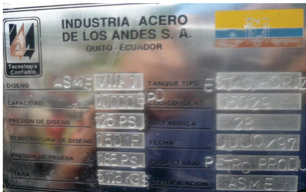
FOTO A.2.8. PLACA DE IDENTIFICACIÓN DEL SEPARADOR DE PRODUCCIÓN. ESTACIÓN YULEBRA
