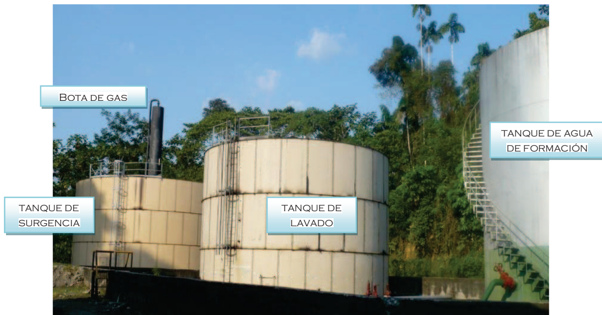
FOTO A.2.10. SISTEMA DE ALMACENAMIENTO Y TANQUE DE AGUA DE FORMACIÓN. ESTACIÓN YULEBRA
