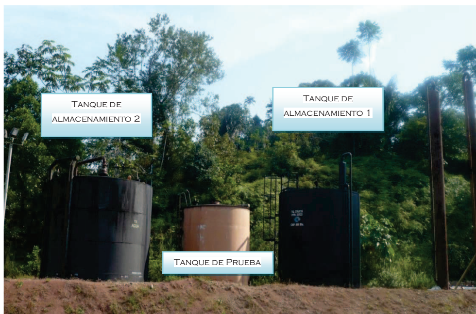
FOTO A.2.21. SISTEMA DE ALMACENAMIENTO. ESTACIÓN ANACONDA
