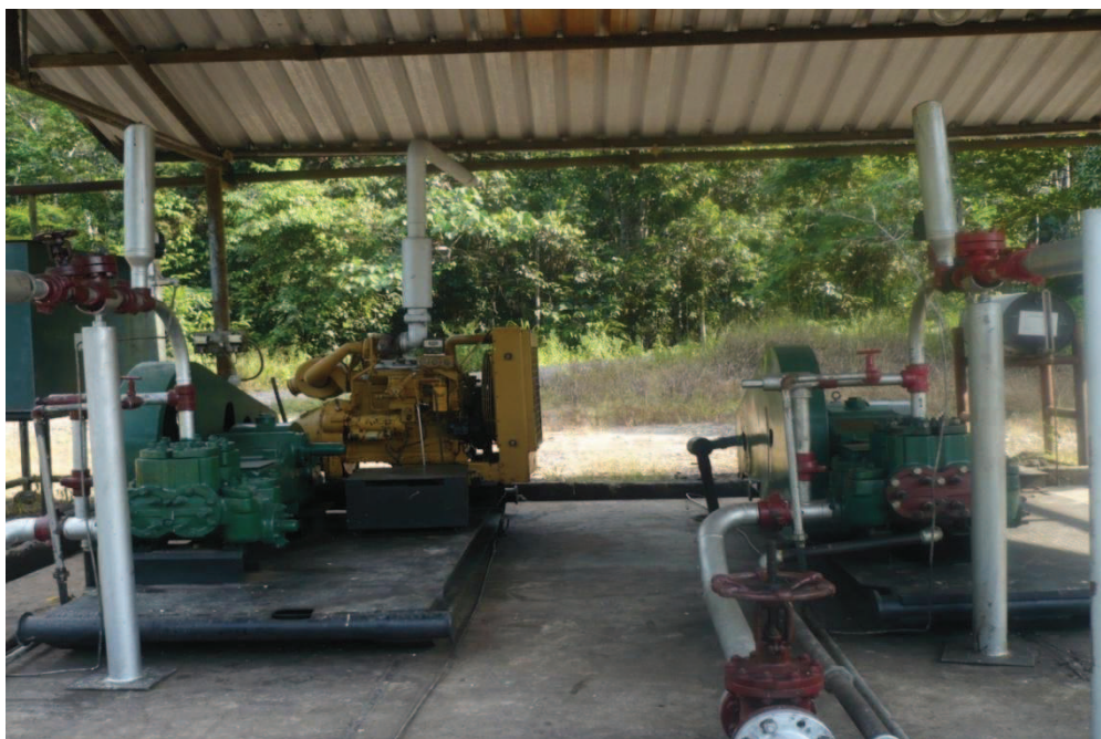
FOTO A.2.23. SISTEMA DE BOMBEO. ESTACIÓN ANACONDA
