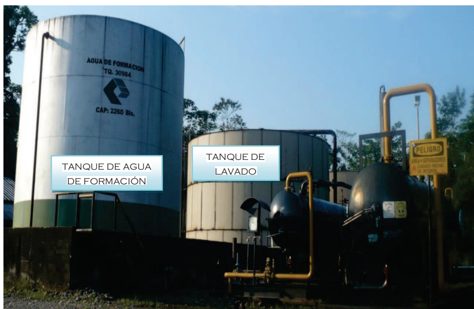
FOTO A.2.11. SISTEMA DE REINYECCIÓN DE AGUA, TANQUE DE AGUA DE FORMACIÓN. ESTACIÓN YULEBRA.
