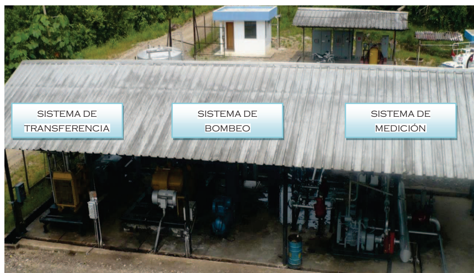
FOTO A.2.14. ÁREA DEL SISTEMA DE MEDICIÓN, BOMBEO Y TRANSFERENCIA. ESTACIÓN YULEBRA.
