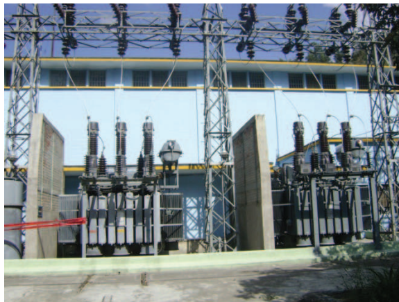
Figura 2.14. Patio de elevación CH. Cumbayá.
