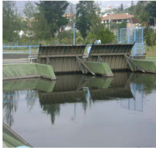
b. Compuerta radial 3 y radial 4.
