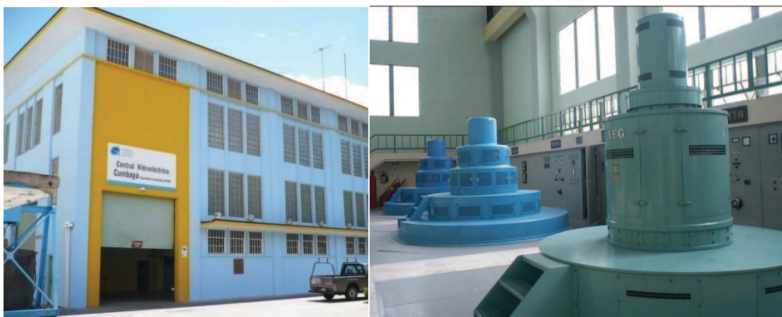
Figura 2.12. Casa de máquinas CH. Cumbayá.
