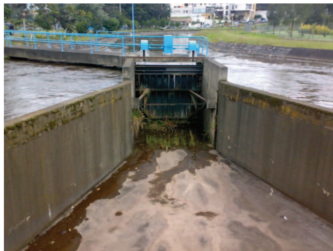
Figura 2.6. Compuerta de acceso al aliviadero.
