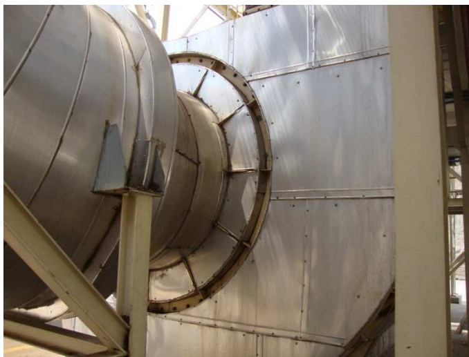
FIGURA 2.14 FAN PRINCIPAL DEL SECADERO
