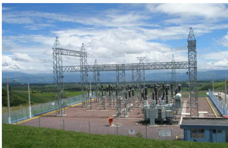
Fig. 1.14 Subestación El Carmen
