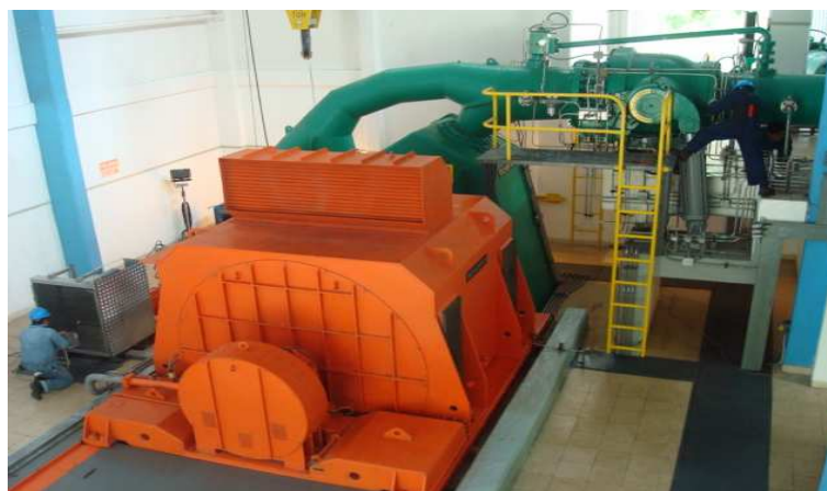
Fig. 1.6 Grupo turbina-generador de la central hidroeléctrica Recuperadora
