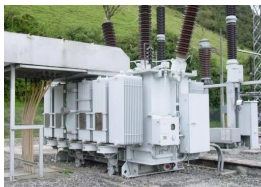
Fig. 1.8 Transformador de potencia
