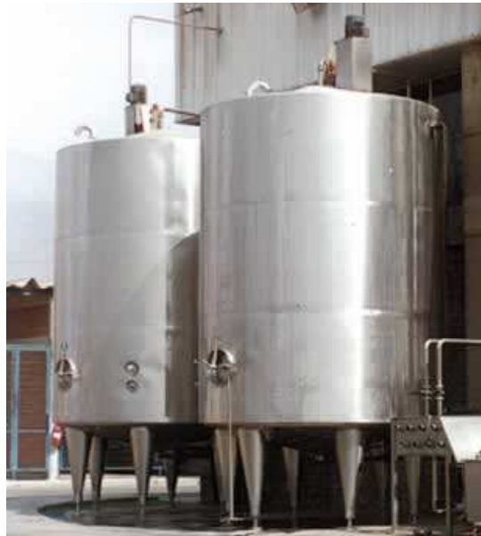
Figura 1.13 Tanque de almacenamiento vertical
