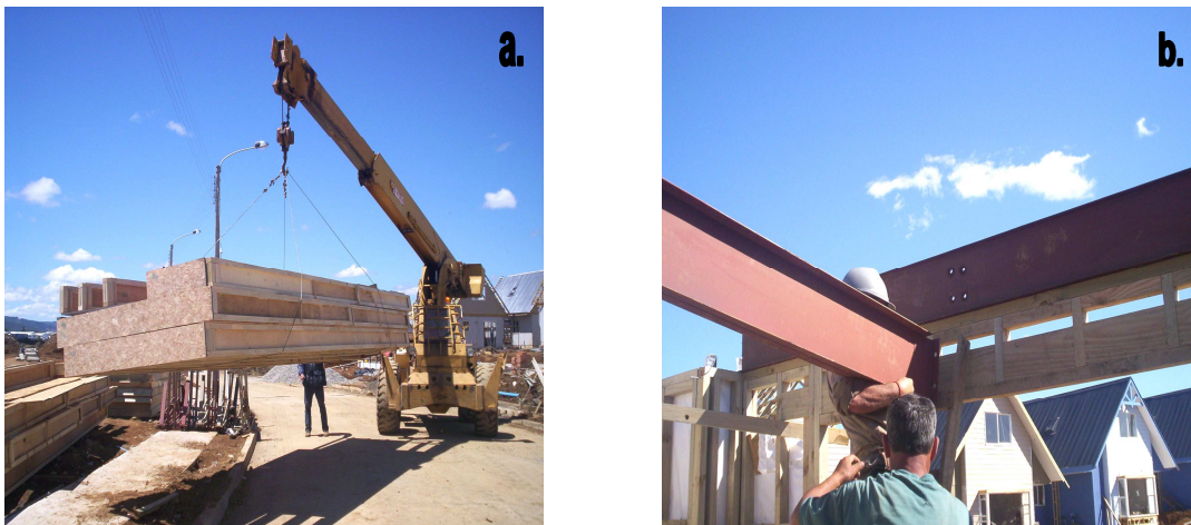
Fig. 5.44 a. Descarga del entramado de entrepiso en obra con una grúa b. Colocación de correas metálicas sobre el entramado vertical, las cuales servirán como apoyo al entramado de entrepiso
