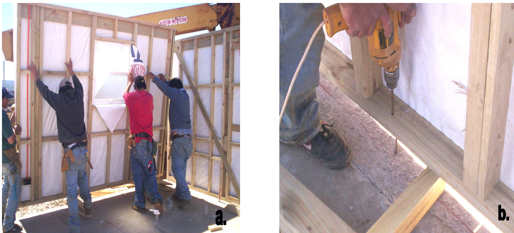
Fig. 5.35 a. Montaje del entramado vertical con la intervención de cuatro carpinteros b. Perforación de la solera inferior para anclar el panel a la plataforma de hormigón
