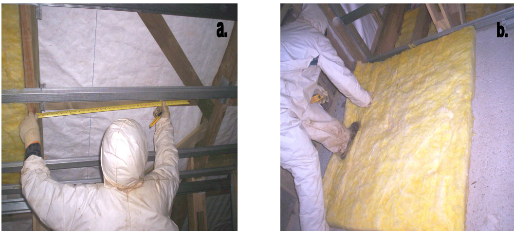
Fig. 6.9 a. Medición del área en el tablero que se va a aislar b. Cortado de lana de vidrio para su instalación en el entramado a aislar.
