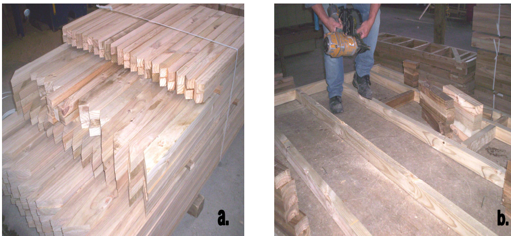
Fig. 5.27 a. Piezas de madera cortadas y figuradas para la elaboración de los entramados verticales b. Fabricación del entramado vertical
