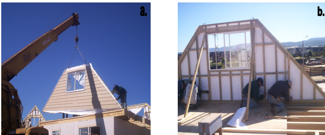
Fig. 5.48 a. Elevación de frontón con la utilización de una grúa. b. Montaje del frontón
