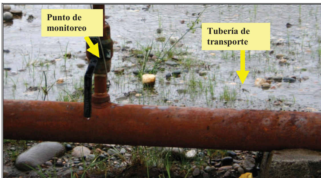
Figura3.9 Ubicación del punto de monitoreo de cupones de corrosión en la tubería de transporte
