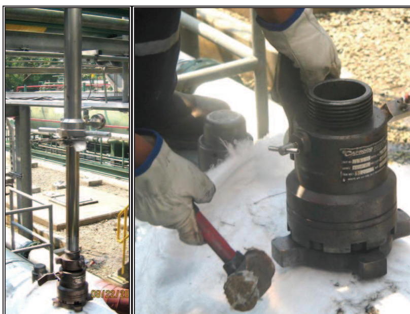
Figura 2.3. a) Retriever y b) válvula para retiro e instalación de cupones de corrosión
