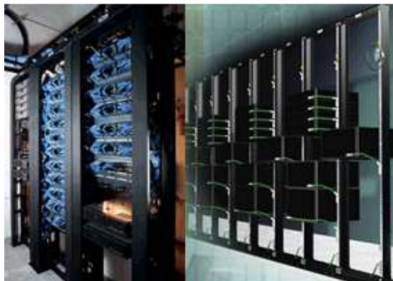
FIGURA 1.35 CUARTO DE TELECOMUNICACIONES
