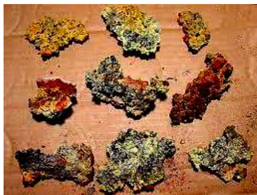
Figura 3.2. Escoria de incombustos producida por la combustión del fuel oil residual. Incrustadas en el interior del caldero
