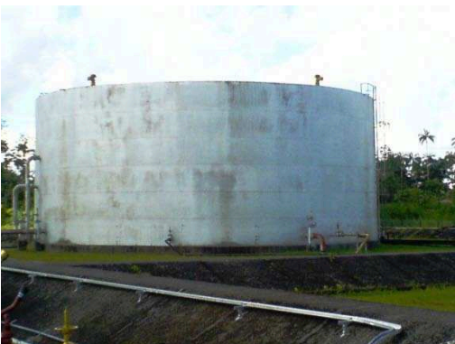
Foto 11. Tanque de Surgencia
