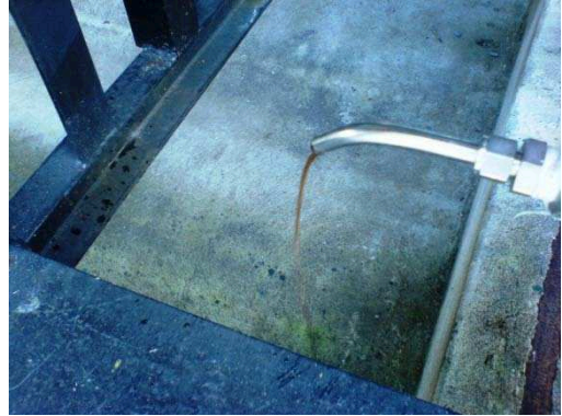
Foto 14. Descarga de Gas FWK01
