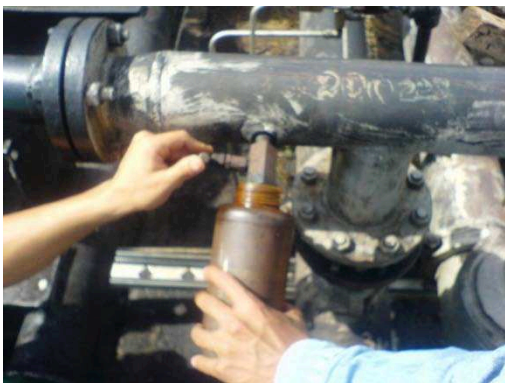
Foto 17. Descarga de Agua FWK02
