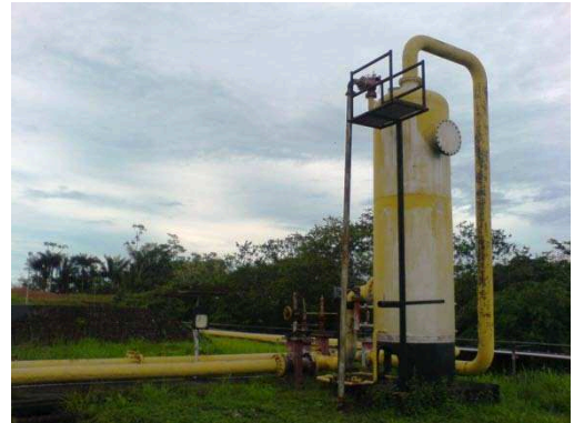
Foto 4. Depurador de Gas
