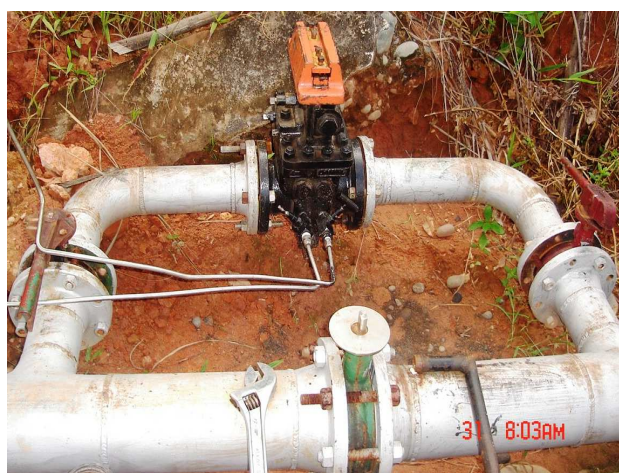
Fotografía 2.4 Portador de Placa Orificio Marca Daniel. Estación Yuca Sur 02
