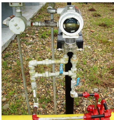
Fotografía 2.3 Medidor Floboos. Estación Palanda en línea de gas separador.
