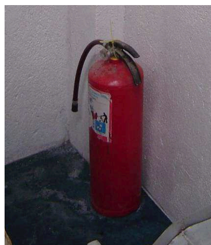
Compra de extintores
