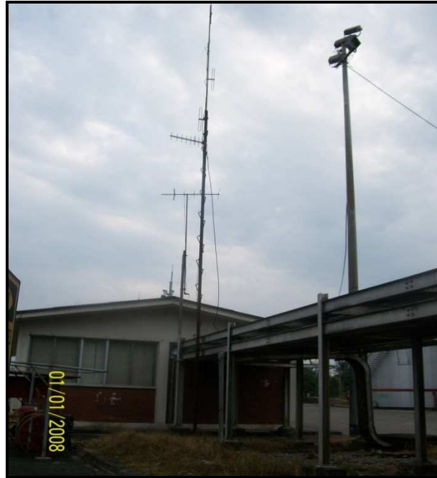
Figura 1.5. Estación Planta de Gas
