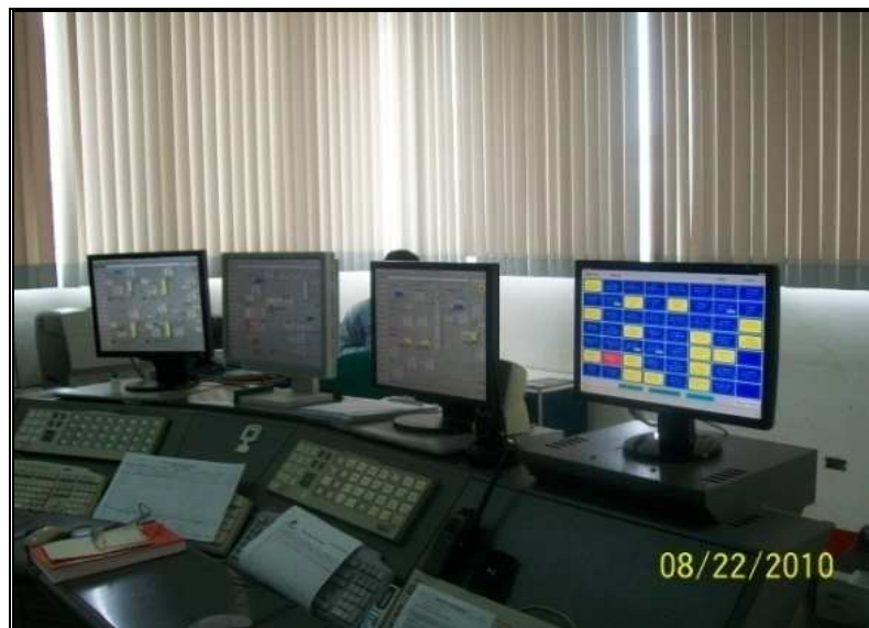
Figura 1.6. Monitores del sistema SCADA para la captación de gas
