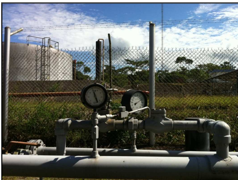
Figura 4.1. Sensor analógico donde se muestra la presión de entrada y salida del gas
