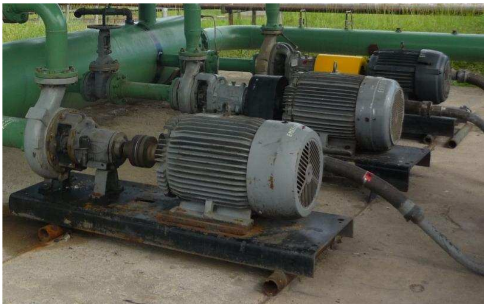
FOTO 12 ACUMULADOR Y BOMBAS BOOSTER CON PARTES OXIDADAS POR FUGAS DE AGUA.
