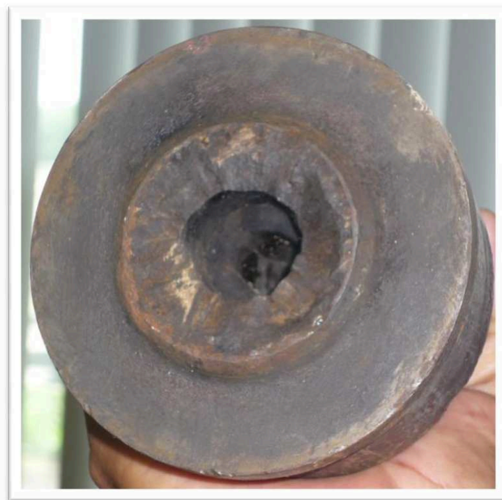
FIGURA 4.6 TUBERÍA TAPONADA CON ESCALA
