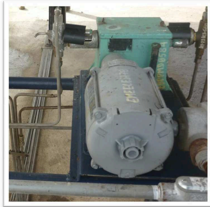
FIGURA 3.9 BOMBA BOOSTER PARA INYECCIÓN DE QUÍMICOS
