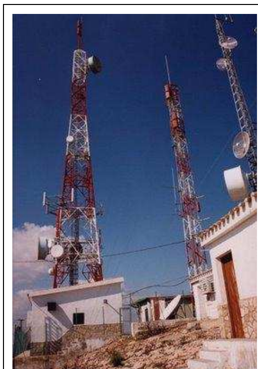
Fig. 1.28 Estación repetidora activa
