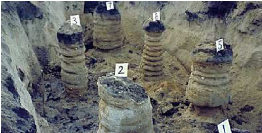
Fotografía 4.1: estructuras formadas por Jet Grouting. (Tomado de: Earth Tech Geotechnical Construction Services and solutions. http://www.earthtech.net ).
