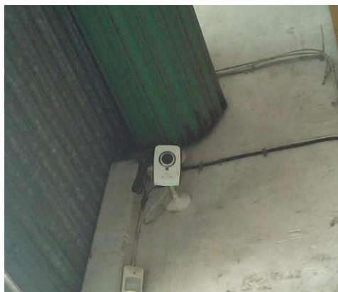
FIGURA 3.17 COLOCACIÓN CÁMARA EN FACTURACIÓN
