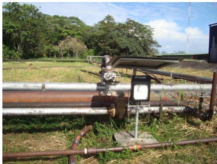
Figura 4.10 Medidor de Consumo de Gas de Central de Generación Shushufindi
