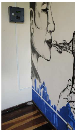
Figura 3-10. Ingreso de voltaje alterno a la unidad central desde un tomacorriente cercano.
