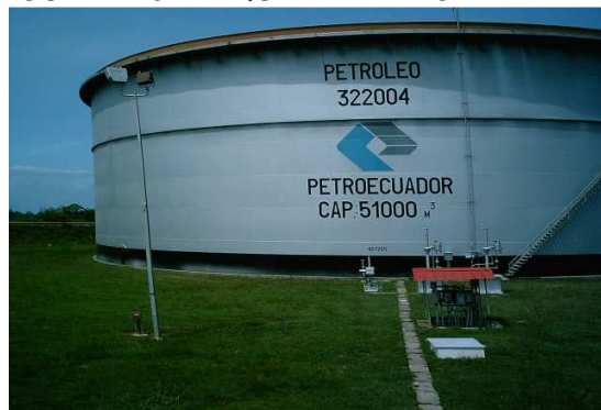
FIGURA 2.20 TANQUE DE ALMACENAMIENTO
