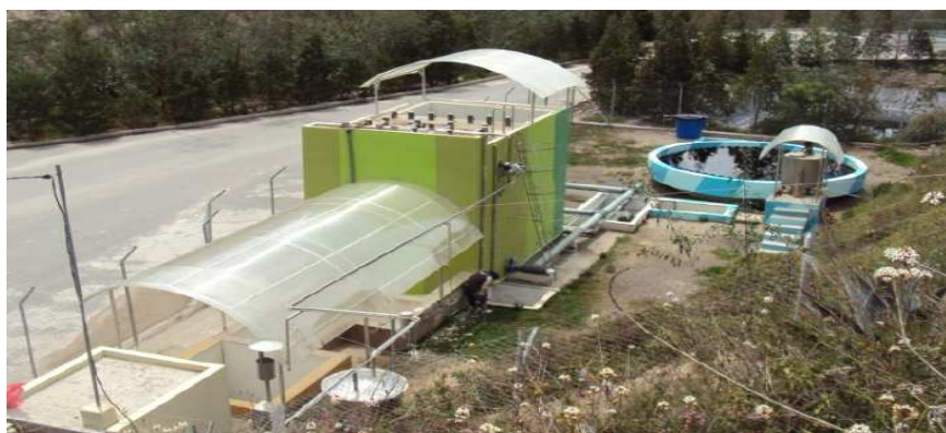
FOTOGRAFÍA 3. 6.- PLANTA DE TRATAMIENTO DE LIXIVIADOS
