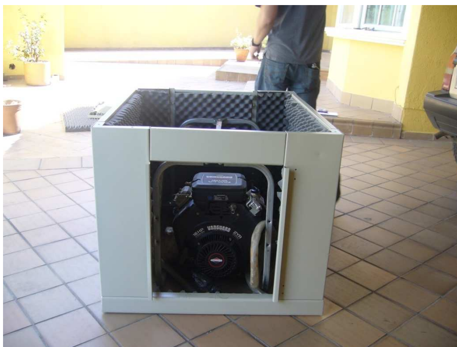
Figura Nº 4.14 Cabina Instalada en grupo electrógeno
