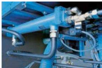
Figura 2-21 Refrigeración por agua
