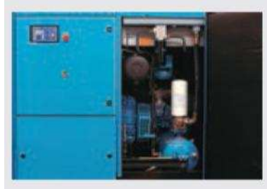
Figura 2-18 Armario de distribución del compresor
