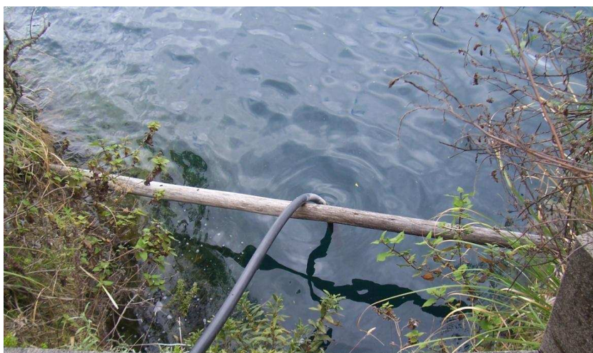
Foto 2.1: Tubería de toma de agua de la laguna
