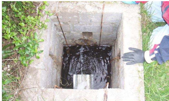
Foto 2.12: Sitio 5 (punto final del sistema de aplicación al suelo)
