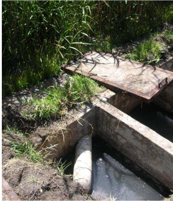
Foto 2.5: Ingreso del agua residual al humedal
