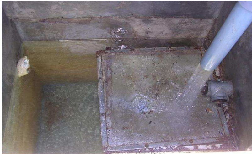
Foto 2.2: Tanque de llegada y filtración de sólidos gruesos
