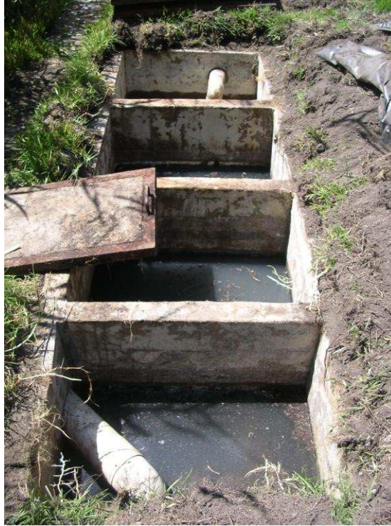
Foto 2.4: Tanque sedimentador de cuatro cámaras
