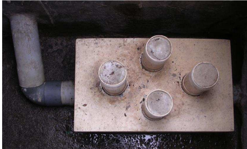
Foto 2.3: Sistema de cloración de la hostería
