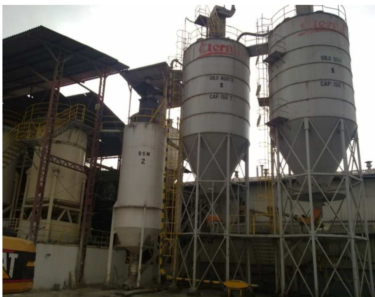
Figura 2.8 Tanques de alimentación de cemento y RSM,
