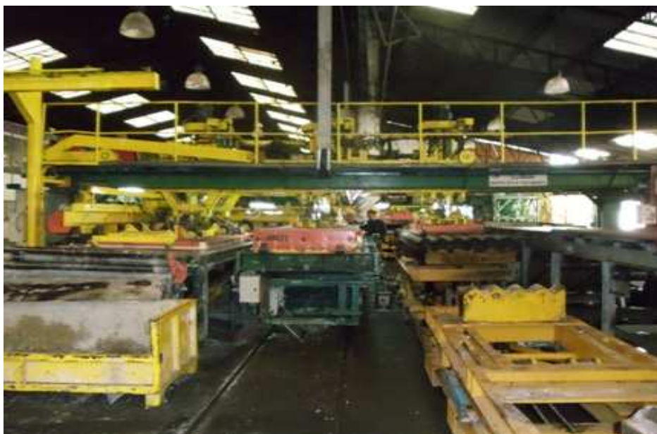
Figura 2.22 Pórtico 2 vista posterior, ventosas abajo, en el lado banda de pasta
