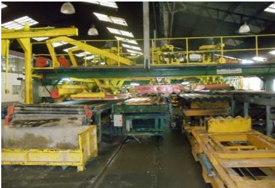
Figura 2.21 Pórtico 2 vista posterior, pórtico trasladándose hacia banda transportadora de pasta.
