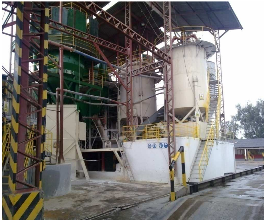
Figura 2.7 Planta de lodos, se pueden observar los tanques denominados Kronnemberg donde se almacenan los lodos y se los mantiene en constante movimiento antes de ingresar al proceso.
