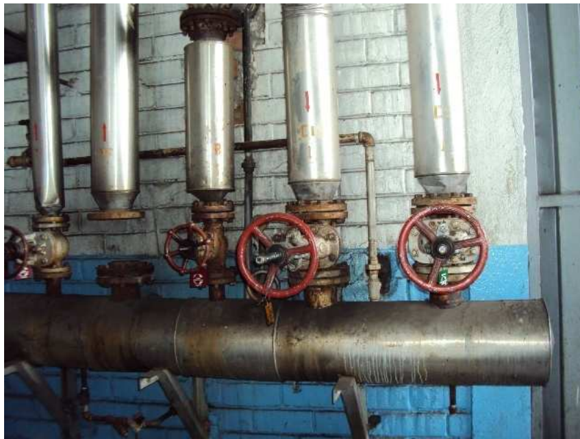
Figura 2.12. 23 Ducto de reparto de vapor.
