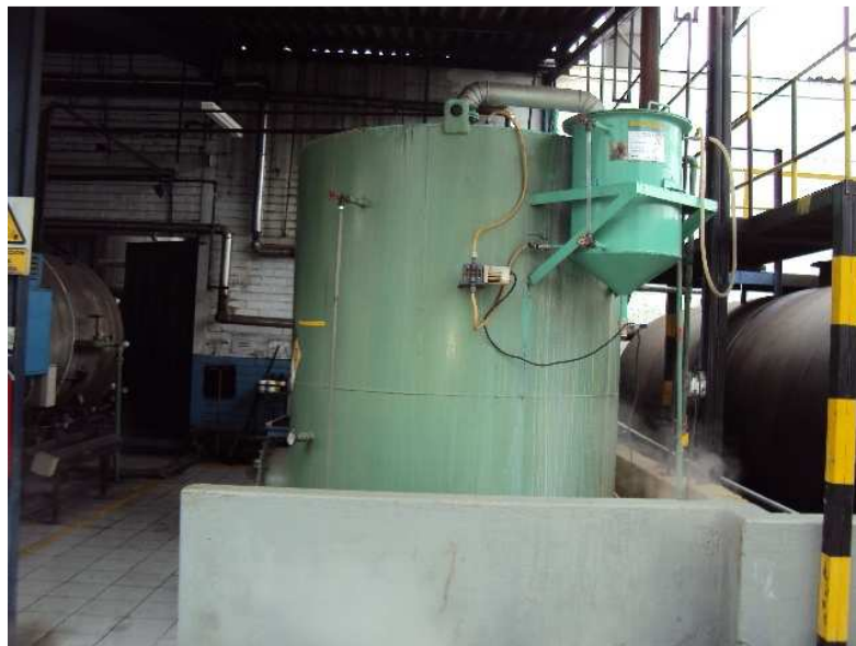
Figura 2.9. 20 Tanque de condensados y agua de alimentación a calderas
