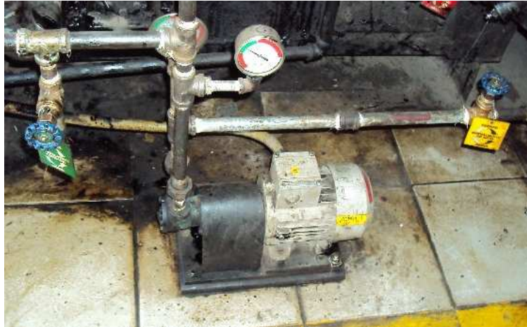
Figura 2.6. 16 Bomba TUTHIL de abastecimiento de combustible al quemador
