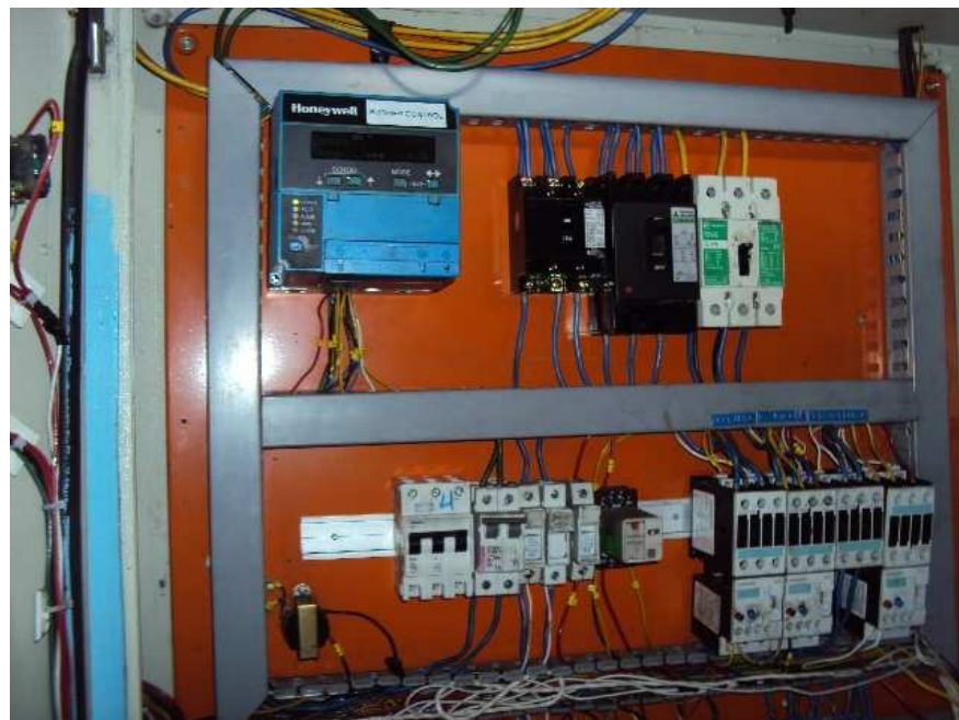
Figura 2.11. 22 Tablero de Control
