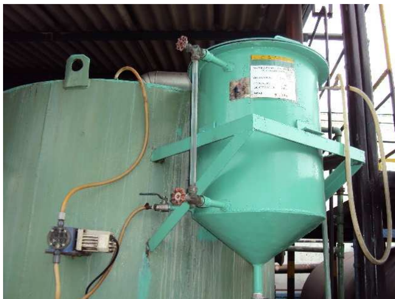
Figura 2.10. 21 Tolva de químicos y Bomba dosificadora
