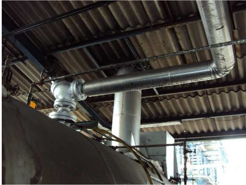
Figura 2.13. 24 Ducto de distribución de vapor a la salida de la Caldera.
