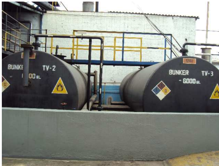
Figura 2.3. 13 Tanques de almacenamiento
