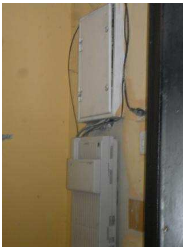
Figura 1.15. Imágenes del estado del cableado y cuarto de telecomunicaciones del Municipio de Quinindé
