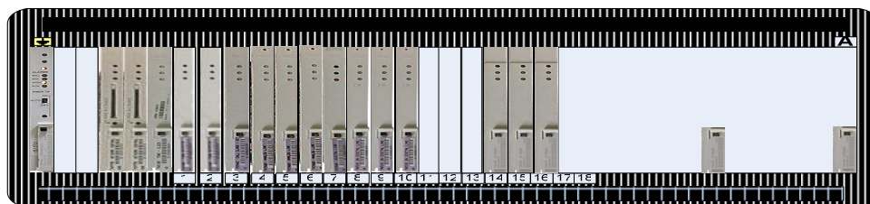
Figura 2.9 Gabinete A de la central telefónica Definity ECS de la EPN.
