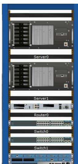
FIGURA 2.6 RACK ORGANIZADO CON SUS EQUIPOS
