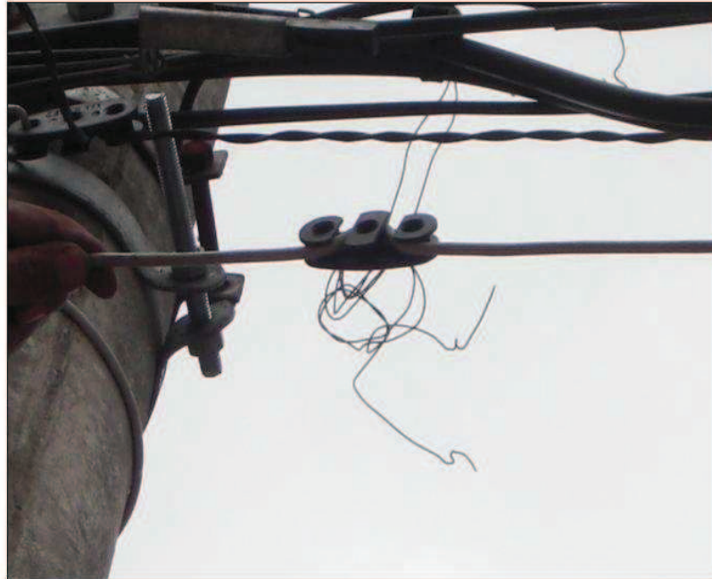
Figura 1.10: Tensores en el cableado externo
