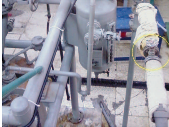
Figura 2.15 Válvula para hacer vacío en el tanque
