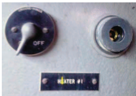
Figura 2.9 Interruptor para la resistencia calefactora 1
