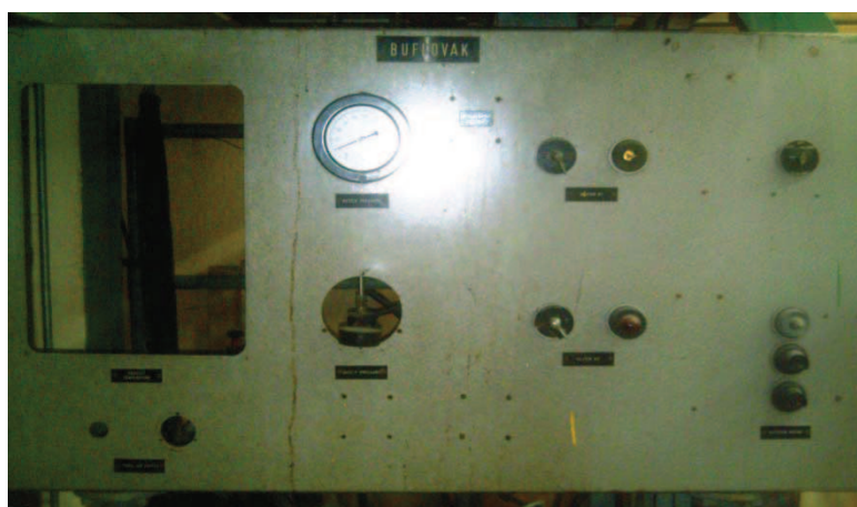
Figura 2.2 Vista frontal del antiguo tablero de control
