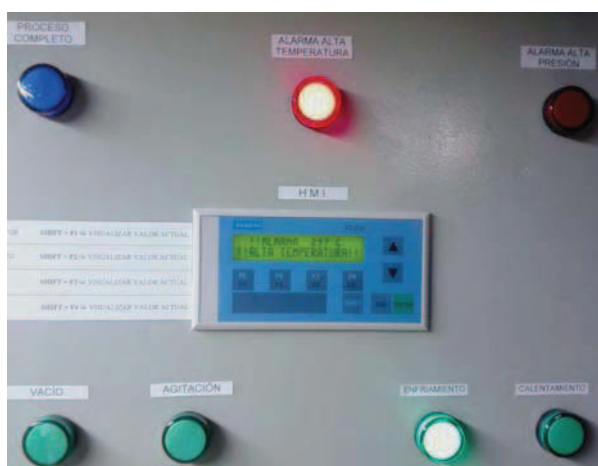
Figura 6.6 Prueba de alarma de alta temperatura
