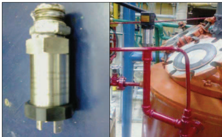
Figura 5.15 Transmisor de presión instalado en la camisa
