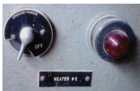
Figura 2.10 Interruptor para la resistencia calefactora 2
