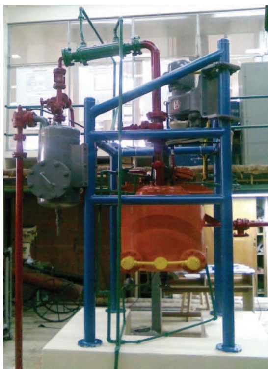
Figura 5.21 Vista frontal del reactor de reacciones químicas
