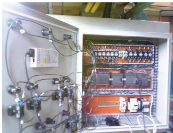
Figura 5.18 Cableado interno del tablero
