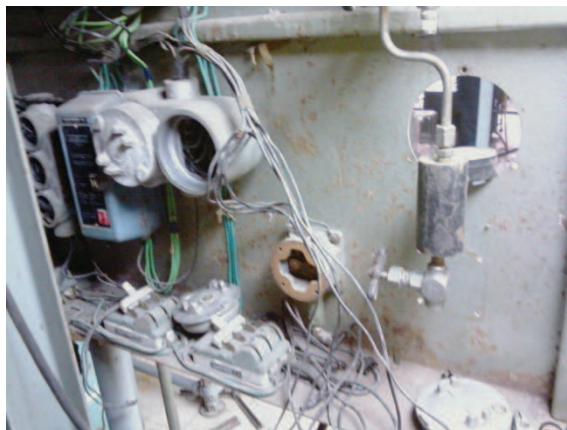
Figura 2.6 Parte del antiguo circuito eléctrico
