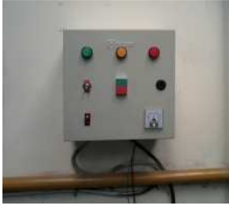
Figura Anexo 5: Instalación finalizada de los componentes. Fuente Propia.
