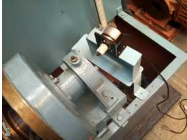
Figura Anexo 2: Fijación del encoder. Fuente Propia.
