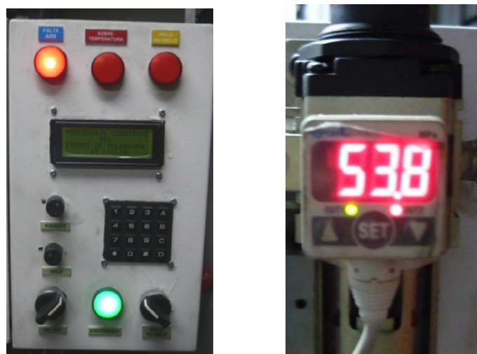
Figura 4.7 a) Tablero indicando falta de aire b) Salida del sensor de aire activada.
