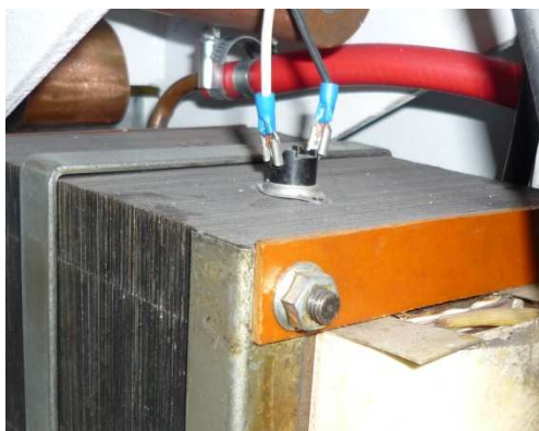
Figura 2.25 Switch de temperatura instalado en la soldadora.
