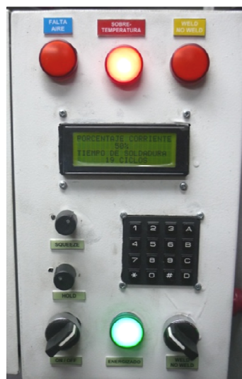
Figura 4.8 Tablero indicando alarma por sobretemperatura.
