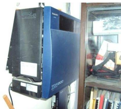
Figura 2.9 Ubicación de la Central telefónica Híbrida Panasonic en el Cuarto de Telecomunicaciones.
