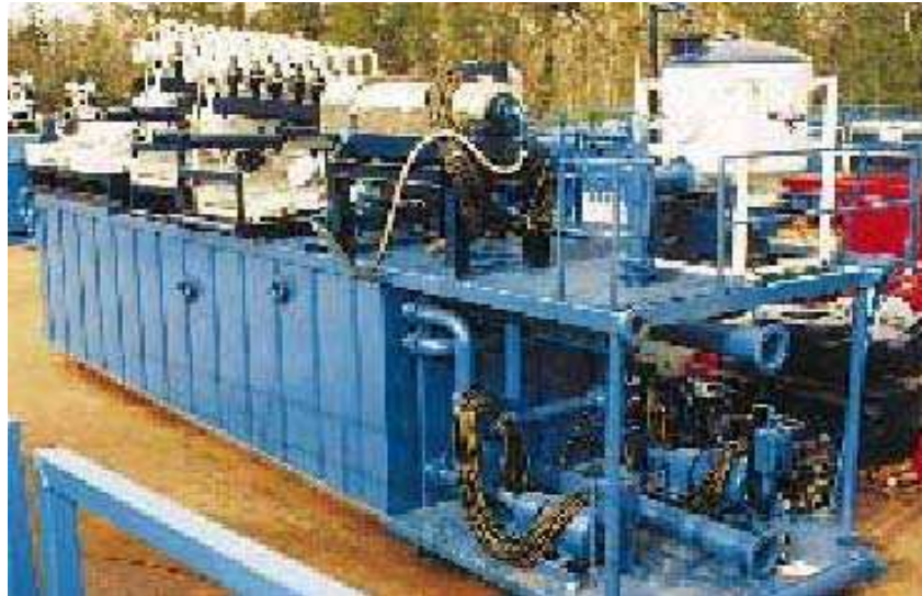
Fig. # 1.37 Tanques de Sedimentación
