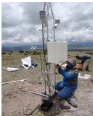
Figura 3.13 Gabinete de Protección
