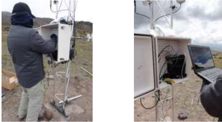
Figura 3.14 Instalación Datalogger Campbell
