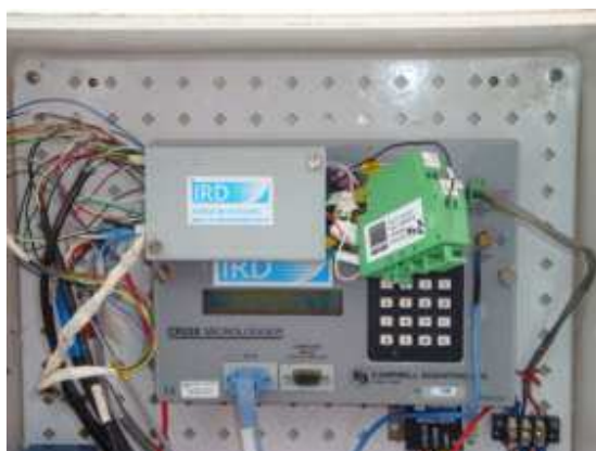
Figura 1.12 Vista del Datalogger instalado en la Estación ORE
