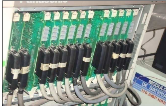
Figura 2.15 Ranuras de la central telefónica de Laboratorios LIFE
