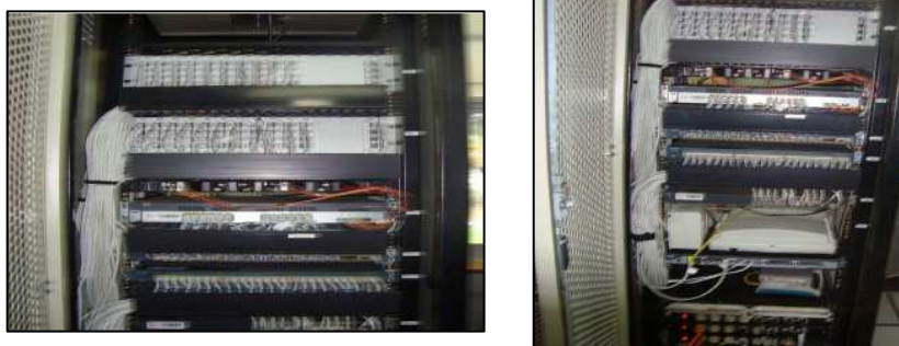
Figura 2.14 Equipos de conectividad del Departamento Administrativo
