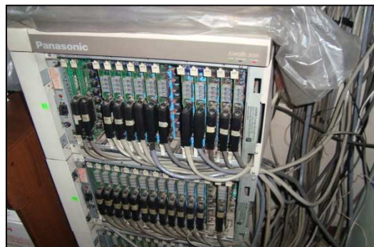
Figura 2.16 Armario de la central telefónica de Laboratorios LIFE
