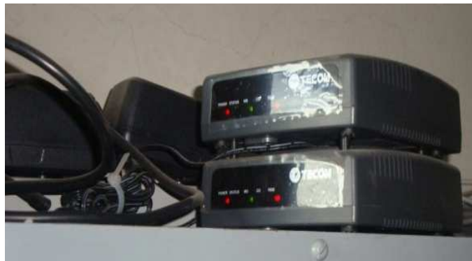
Figura 2.19 Bases celulares de la central telefónica de Quito
