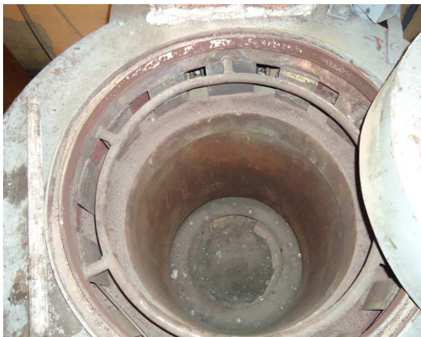
Figura 3.16 Horno N°1 para Pre calentamiento.
